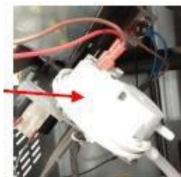
Comutator de presiune al coșului în boiler
